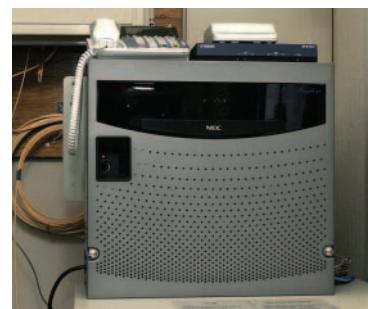
本社に導入された「Aspire」本体。支店や技術センターなど、全国27拠点をつなぐVoIPネットワークを実現している
